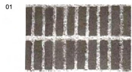
DINTEL ALZADO SUR fábrica armada de ladrillo manual color pardo, juntas anchas enrasadas de mortero mezclado con pequeños áridos de río (1 y 3mm), aparejo de sardíñales.
