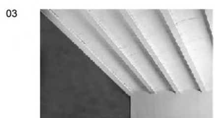
FORJADOS + CUBIERTA forjados a base de viguetas prefabricadas de hormigón y revolones cerámicos con capa de compresión. Acabado interior pintado en color blanco.
